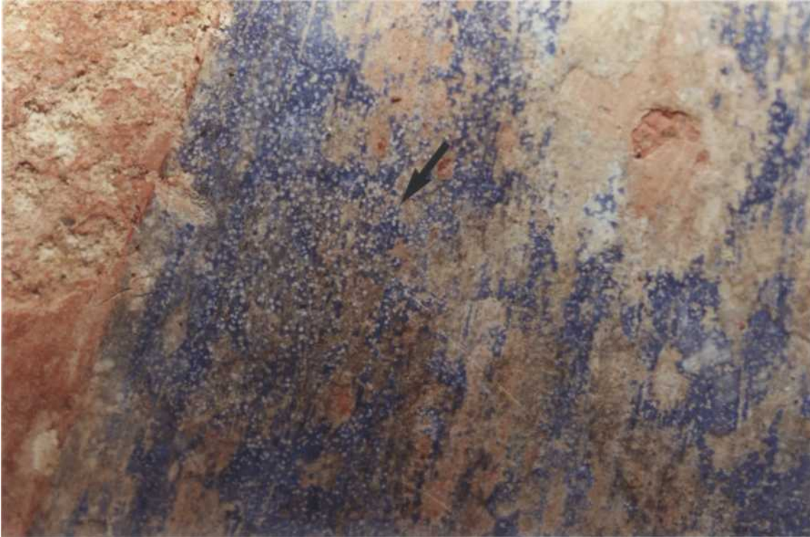
Abb. 62: Blaue Wandmalereischichten. Möglicherweise sind Quarzkörner des Putzes durch Gipskristallisation herausgebrochen und haben die hellen, punktförmigen Hohlräume (z.B. Pfeil) hinterlassen. Bildbreite ca. 8cm.
