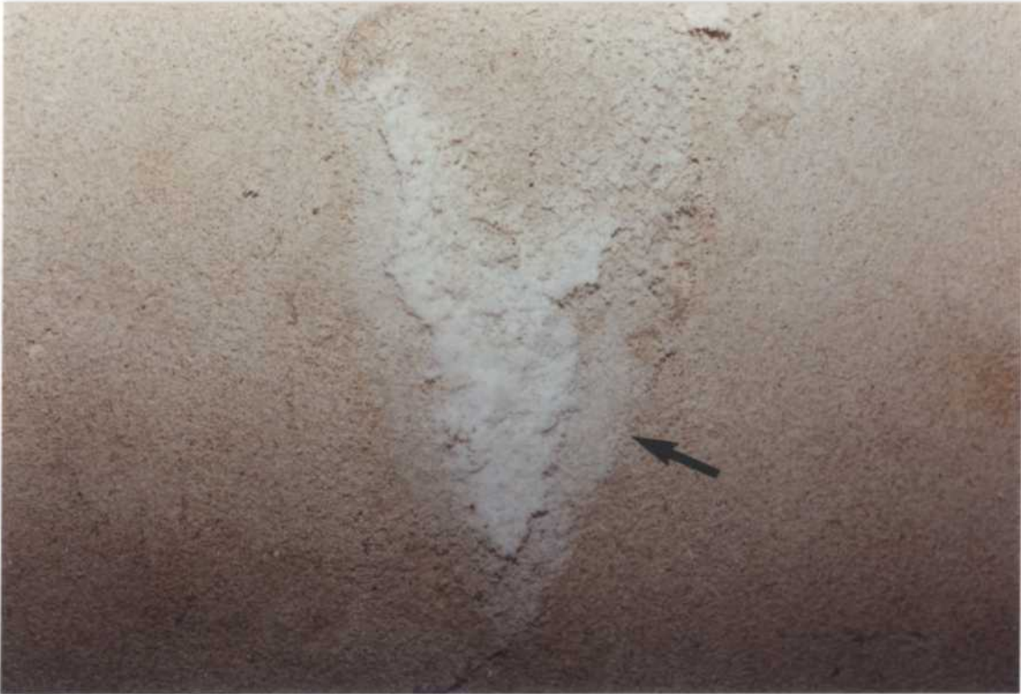
Abb. 76: Im Januar 1991 ist die (alte) traubenförmige Ausblühung von einem Saum frischen Salzes (Pfeil) umgeben. Bildbreite ca. 9cm.
