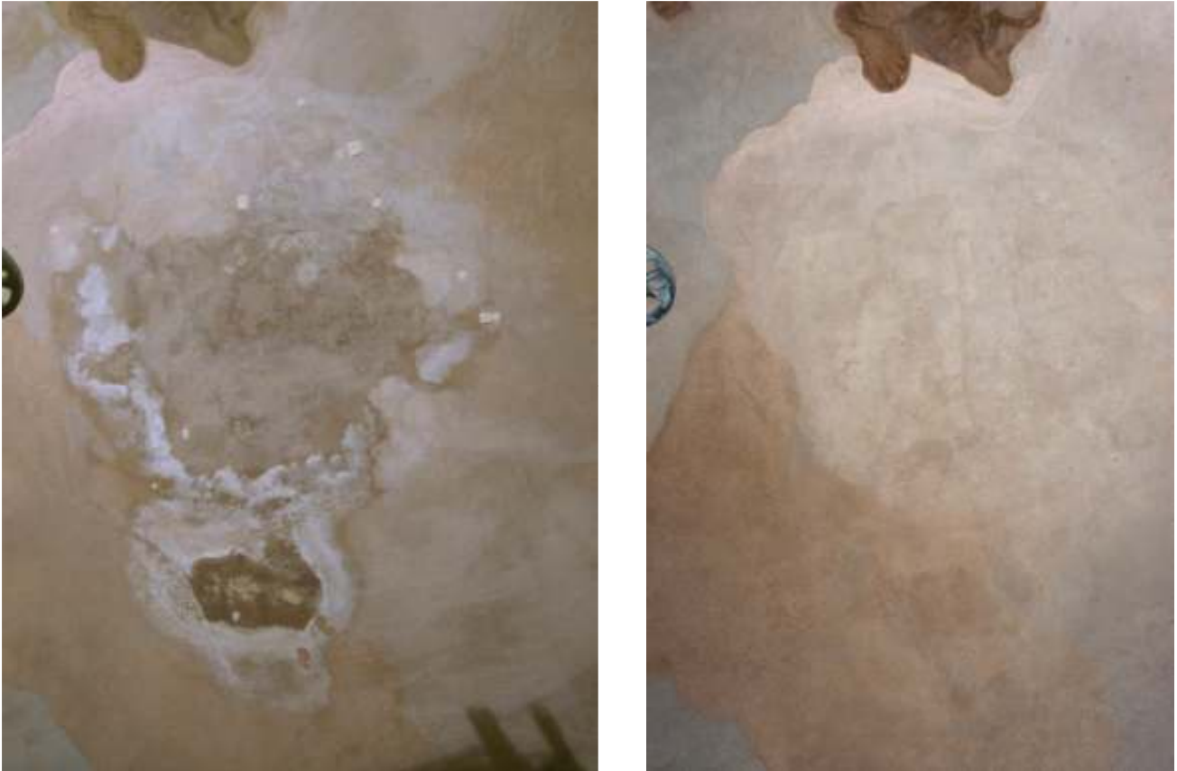
Abbildung 3, 4: Residenz Würzburg, Treppenhausfresko, Gewölbe-West, Gegenüberstellung Vorzustand (3) und Nachzustand (4) eines Salzfleckes nach Ammoniumcarbonatbehandlung (2003-04). (Foto: M. Eiden, genehmigt durch Bayerische Verwaltung der staatlichen Schlösser, Gärten und Seen, Schloss Nymphenburg, 80638 München)
