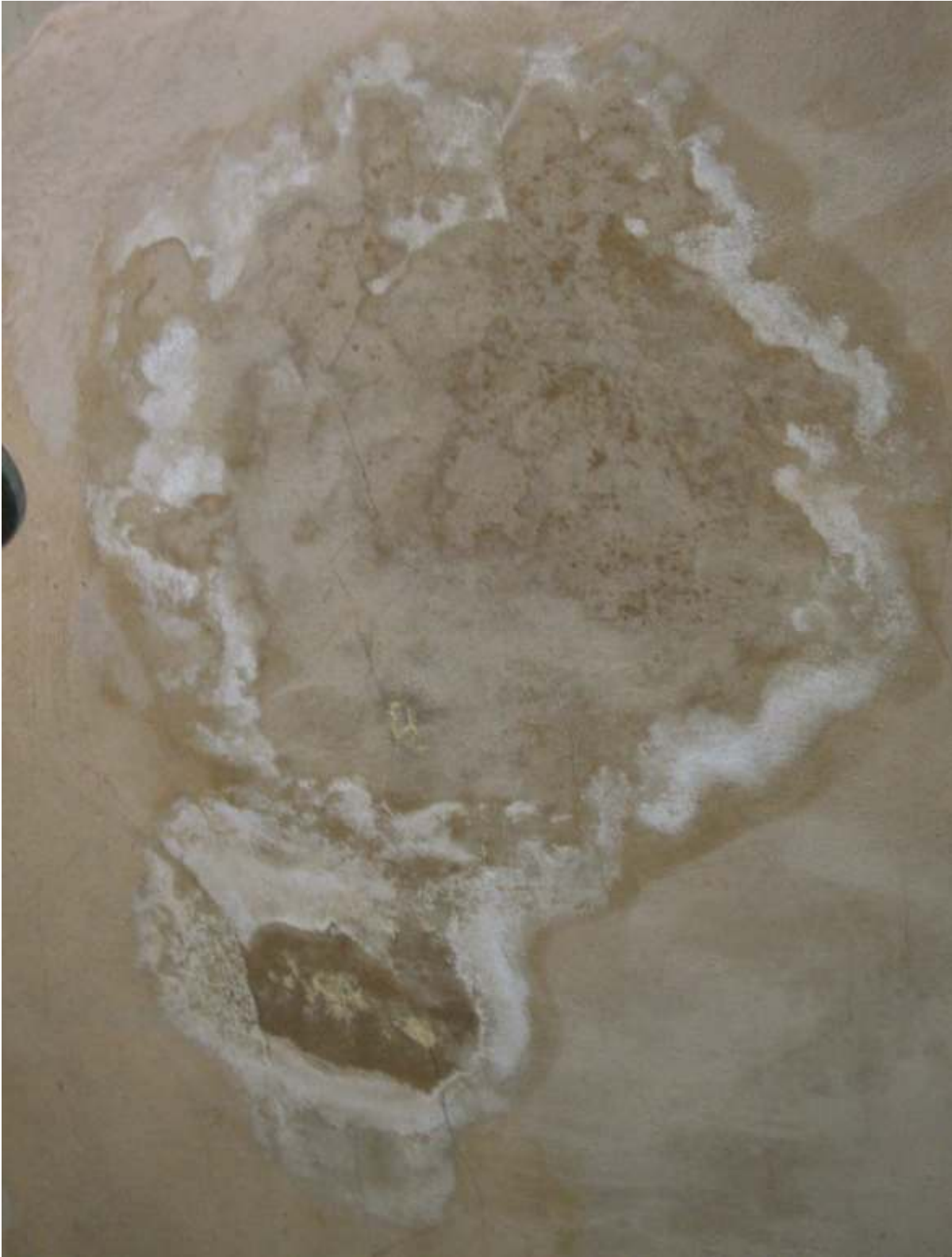
Abbildung 1: Residenz Würzburg, Treppenhausfresko, Gewölbe-West, Salzleck im Wolkenbereich, Zustand 2003 (Foto: M. Eiden, genehmigt durch Bayerische Verwaltung der staatlichen Schlösser, Gärten und Seen, Schloss Nymphenburg, 80638 München)
