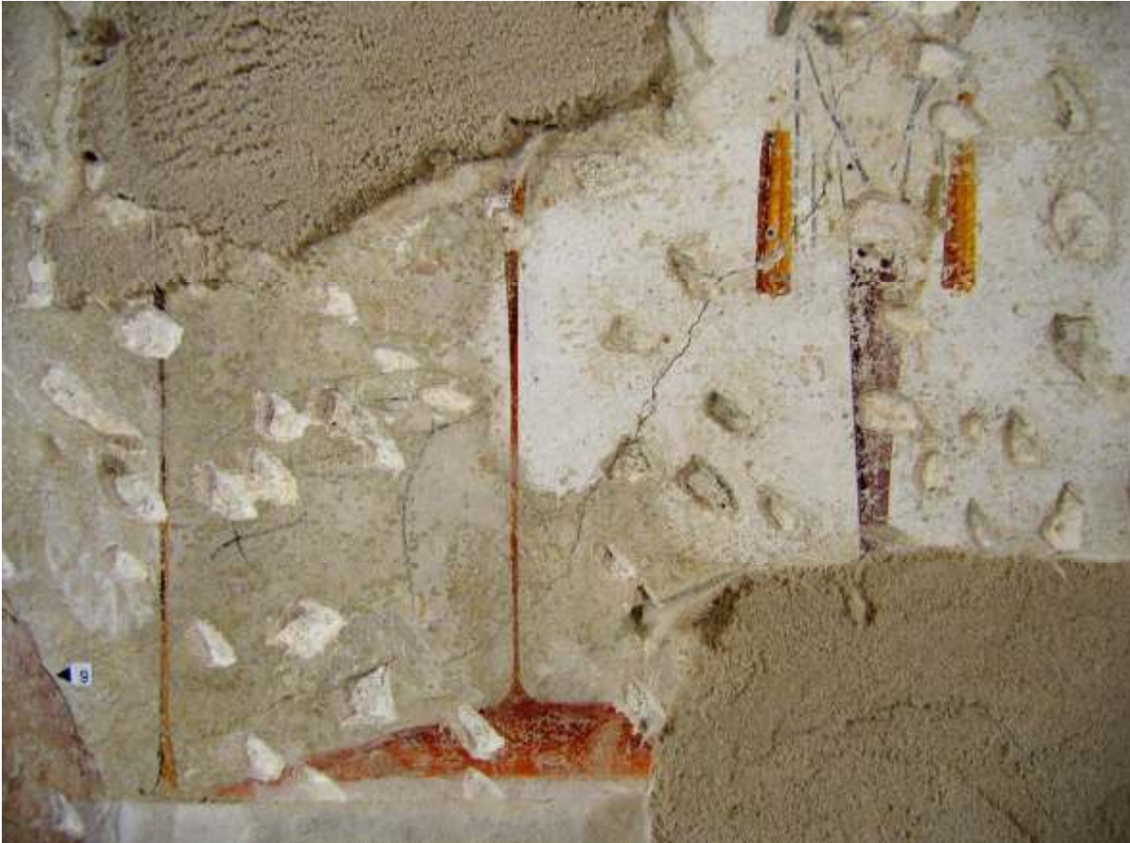
Abbildung 13: Gegenüberstellung von gereinigtem Bereich und ungereinigtem Bereich während der AC-Behandlung (Musensaal Augsburg), (Foto: Markus Eiden, genehmigt durch Hubertus Fürst Fugger-Babenhausen und die Fürst Fugger-Babenhausen'sche Stiftung zur Förderung schwäbischen Kulturgutes)
