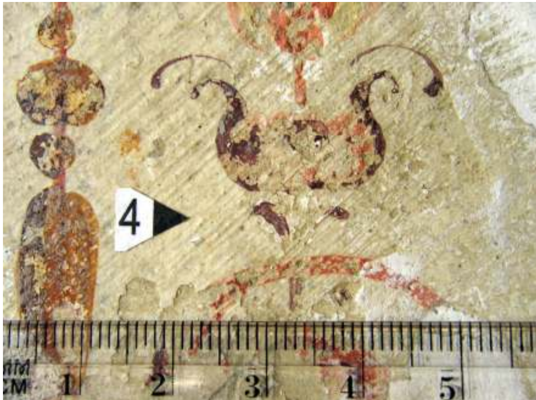
Abbildung 12: Schadensphänomen Gipssinterkruste (Musensaal Augsburg)(Foto: Markus Eiden, genehmigt durch Hubertus Fürst Fugger-Babenhausen und die Fürst Fugger-Babenhausen´sche Stiftung zur Förderung schwäbischen Kulturgutes)
