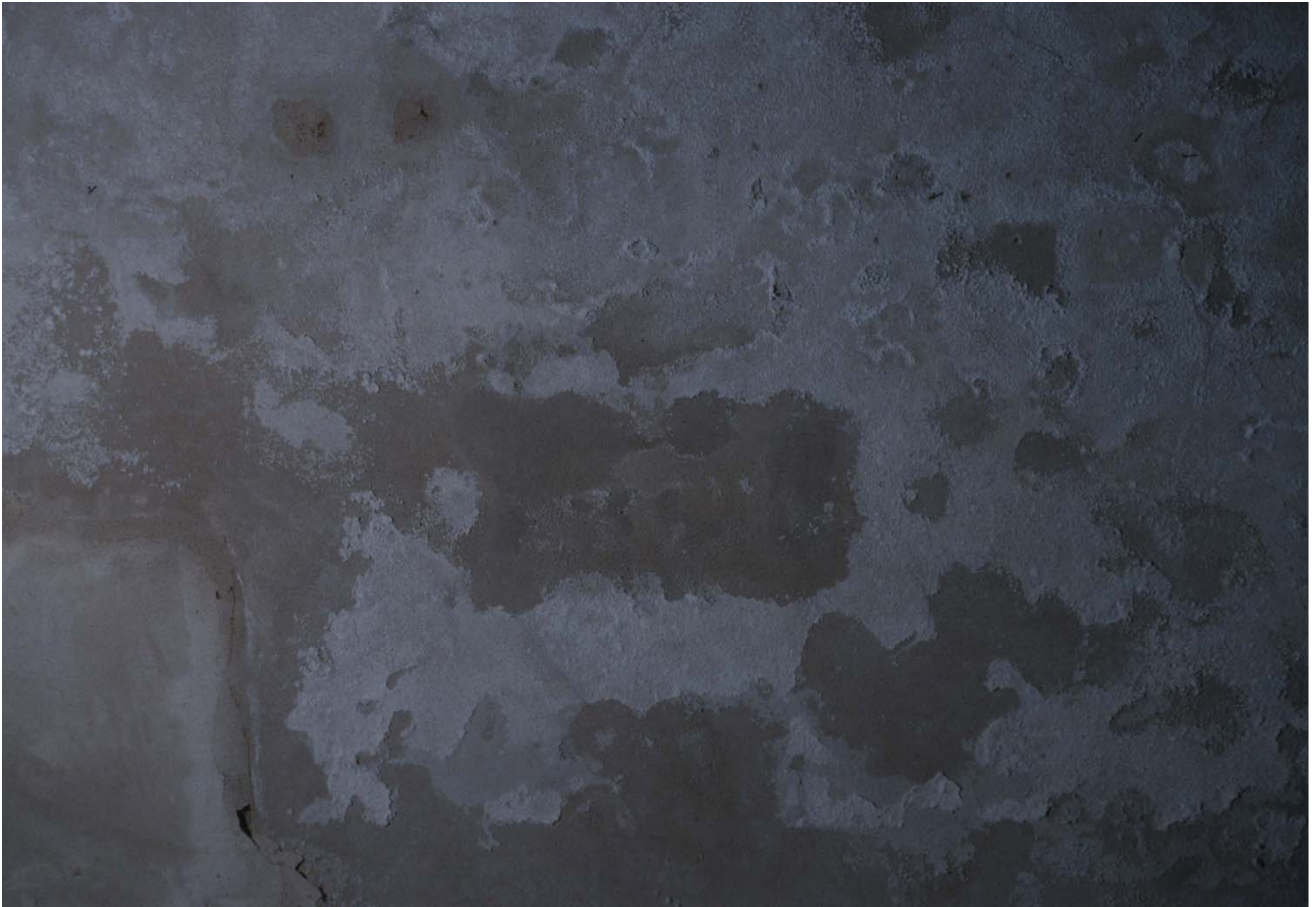
Wand F15 mit Sanierputz und aufliegender Salzkruste, 1994
