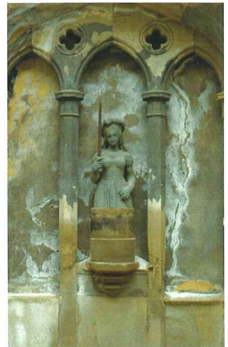
Koblentz, Schloss Stolzenfels, Salzausblühungen auf Putzmörtel
