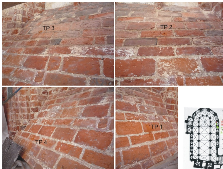
Abb. 19: Position der Tiefenprofile TP 1-TP 4, Südwand des Kirchenschiffes, Sohlbank oberhalb der Seitenkapelle
