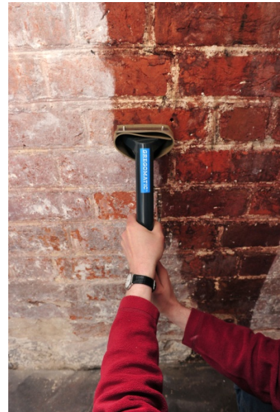
Abb. 24: Dokumentation des erzielbaren Reinigungsgrades - linke Abb.: Beispiel eines partiell gereinigten Gurtbogens – rechte Abb: Einsatz der 13 cm Breitdüse mit Dokumentation des Reinigungserfolges
