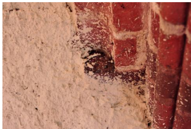
Abb. 15: Auftrag der Cellulosekompresse (von oben: Anmischen, maschineller Auftrag, Nahansicht Oberfläche der aufgetragenen Kompresse)
